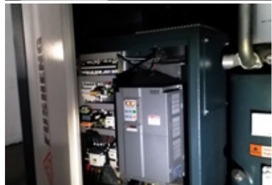
現場安裝之變頻式螺旋壓縮機
