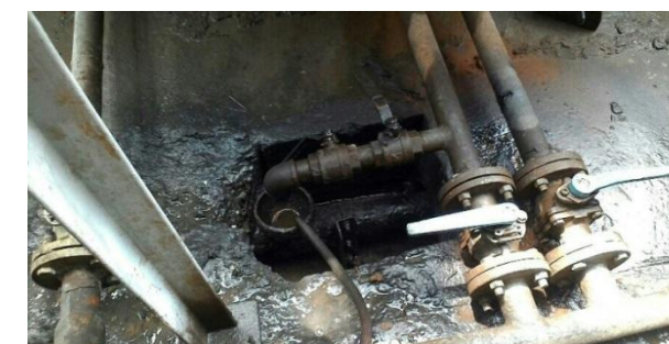
出料口無有效防堵、鋪面不完整
