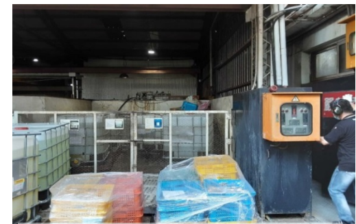
原重油槽曾發生洩漏遭開罰
