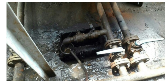
出料口無有效防堵、鋪面不完整
