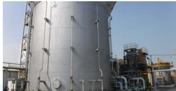
原料槽體、管線地上化、定期巡檢
