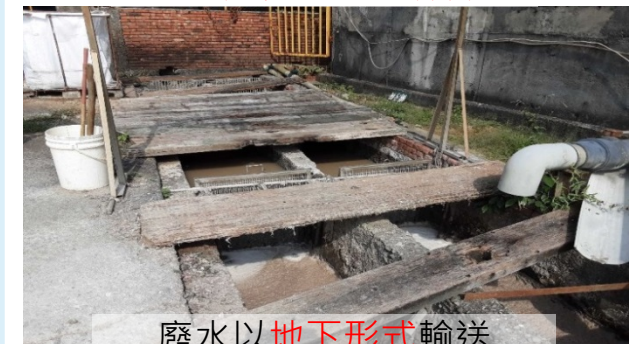
原廢水槽為地下式、無內覆防滲層、有破損
