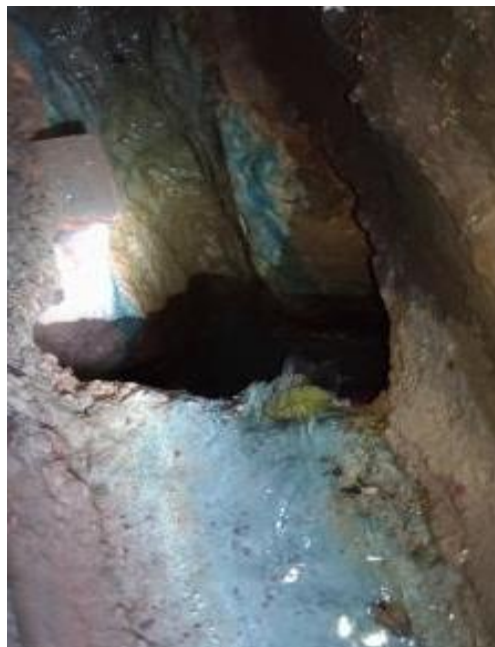
雨水下水道腐蝕出 現大洞，底部明顯 有藍綠色沉澱物。
