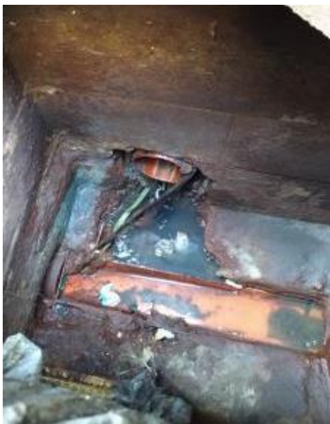
污水下水道腐蝕 出現大洞
