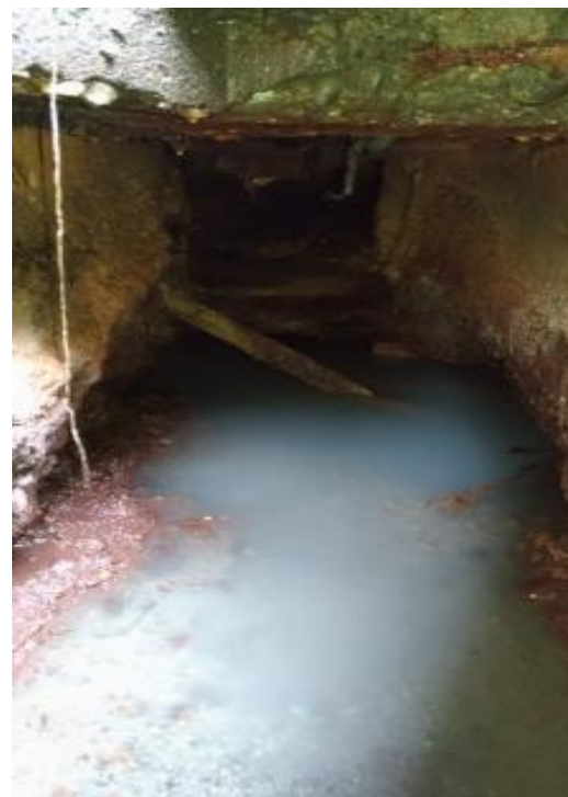
雨水下水道已受腐蝕
